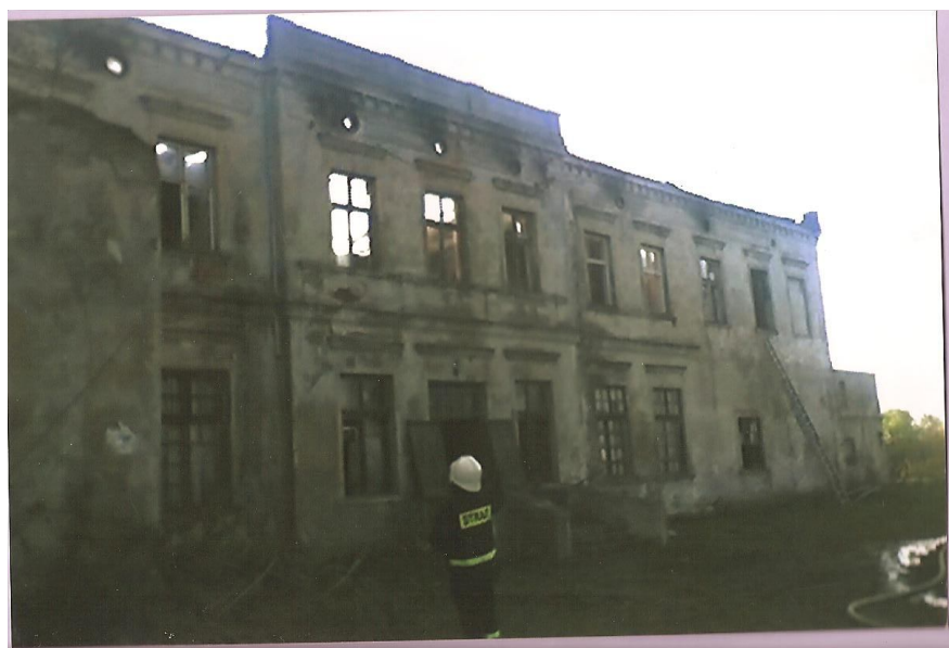
Rys. nr 4. Zabytkowy pałac zaraz po spaleniu 01.05.2007 r.
